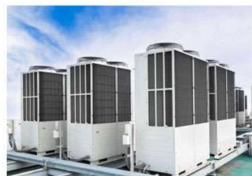
Отопление, вентиляция, кондиционирование
